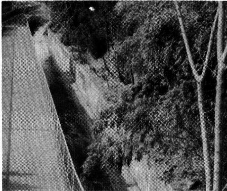
全面改修が望まれる下の川
