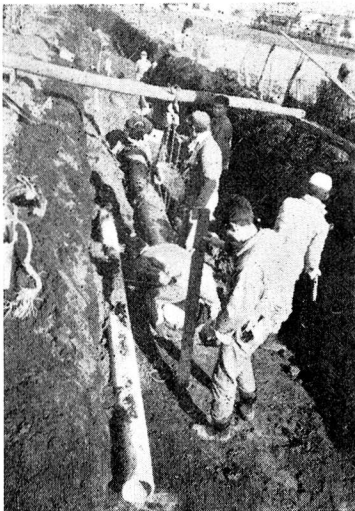
夏の水を確保するため着工中の第3浄水場への導水管工事
