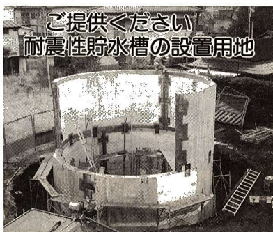
市では、公共施設や市民から用地を借り上げ、現在167基の耐震性貯水槽を設置しています。この施設は、1基でも多く設置することで、震災時の火災などから生命・財産を守ることにつながる貴重な施設です。
