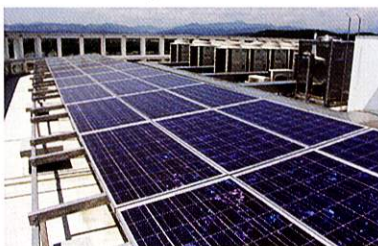
市庁舎屋上の太陽光発電システム
